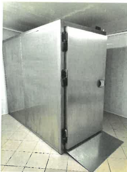
pomieszczenie z chłodnią w zakładzie pogrzebowym
